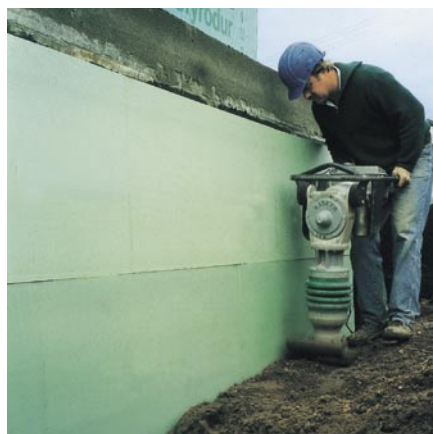
Bild 8/7: Die Baugrube wird lagenweise verfüllt. Die Perimeterdämmplatten sind Schutzschicht für die Abdichtung.
