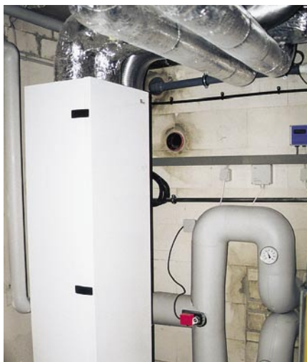
Bild 3/1: Technikräume im Mehrfamilienhaus sind ideal im Keller aufgehoben.
