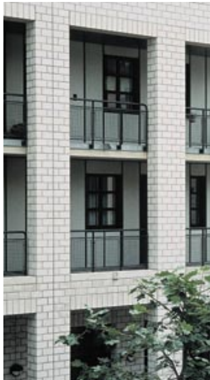
Bild 21: Sichtmauerwerk aus KS-Verblendern, farblos imprägniert, Gebäudetrennfuge in einem Pfeiler
